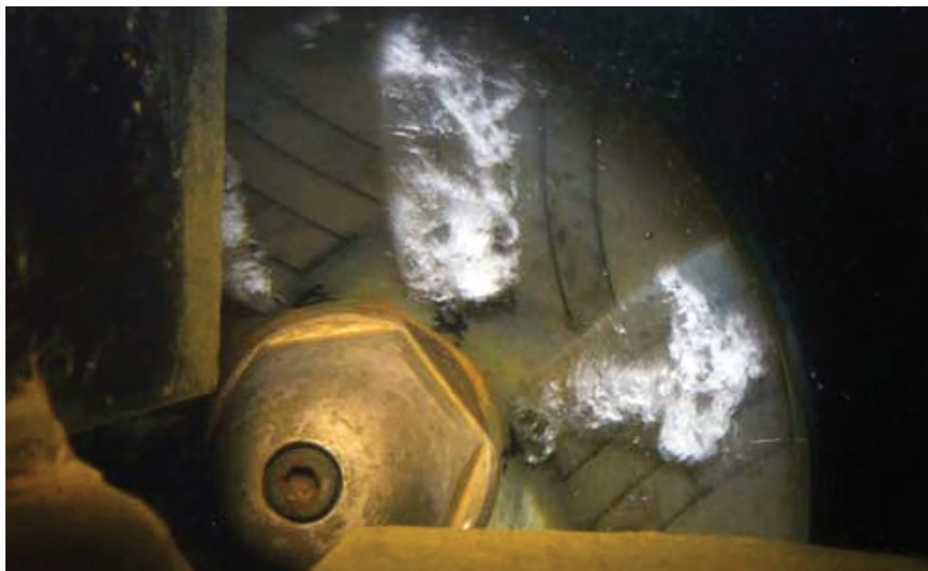
Рис. 38. Кавитация (вскипание перекачиваемой жидкой среды) на входе в рабочее колесо насоса 12
